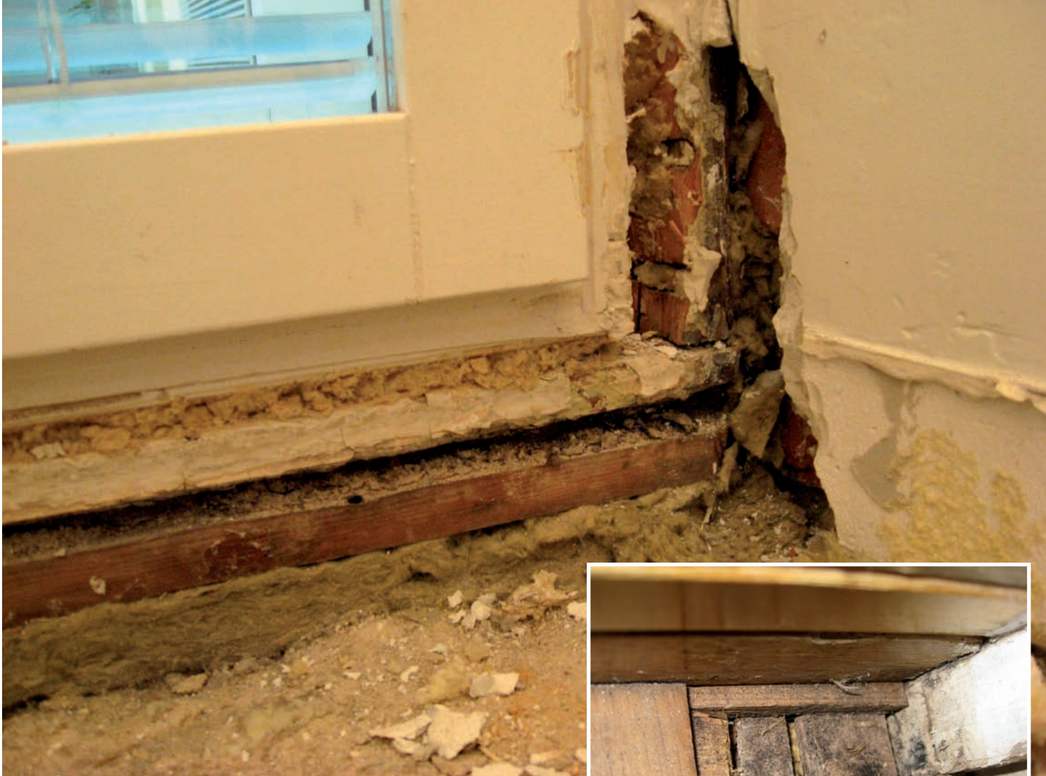
Ikkunat on uusittu, mutta vanhan ikkunan pilaantuneet puuosat ja eristeet on jätetty poistamatta homepommiksi.
